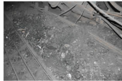
(a) 巷道底板严重处
