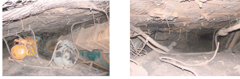
图9 底板冲击后巷道破坏情况
